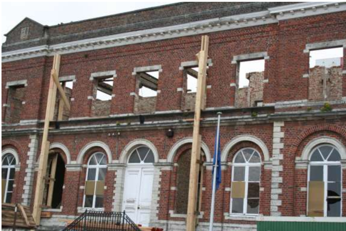
Figuur 138. Het gemeentehuis krijgt een metalen constructie. Het volledige dak gaat eraf
